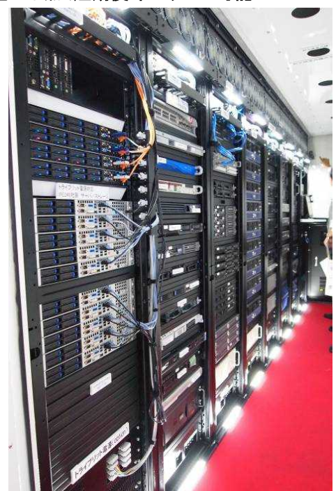
NFH20feetコンテナデータセンタ内部
